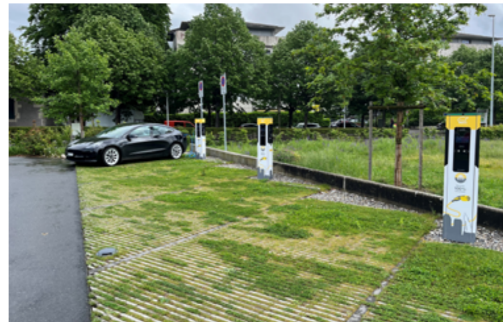
> Bornes de recharge Six bornes installées dans le parking de la Mairie
